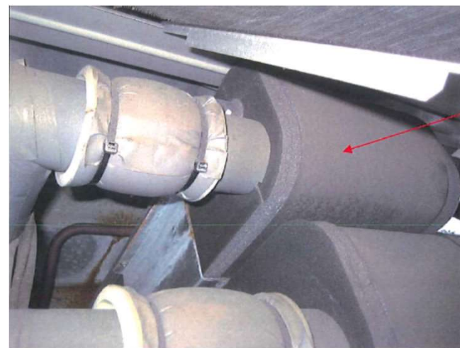
漏えい発生部
